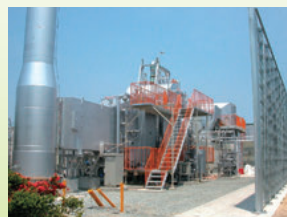
コ・ジェネレーションシステム
