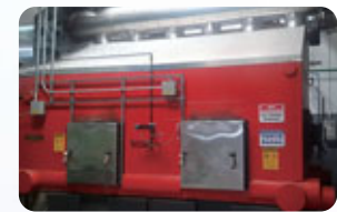
導入したバイオマスボイラー
