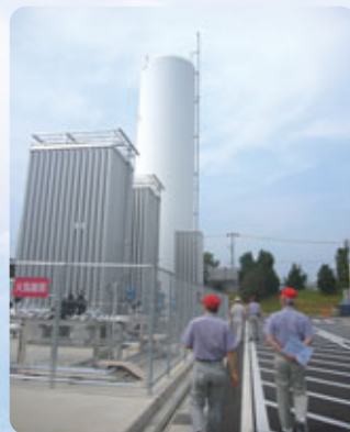
ブリヂストン 磐田工場の天然ガスタンク
