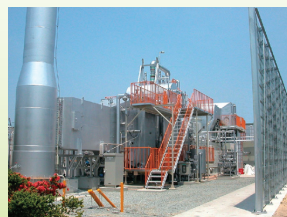
コ・ジェネレーションシステム
