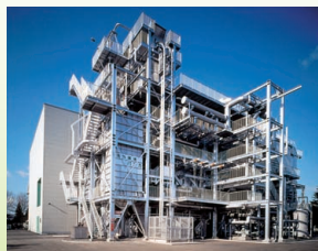
使用済みタイヤ焼却発電設備
