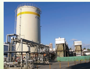
コ・ジェネレーションシステム
