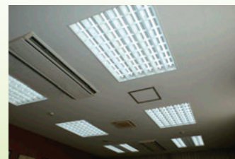
事務所内のLED照明
