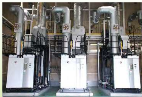
新ボイラーシステム
