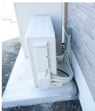
エコキュートの機器裏でヒートポンプ配管を束ねる。
