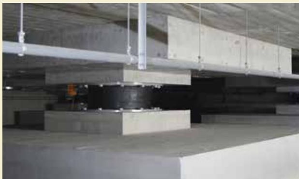
ビット内にあるブリヂストンの免震装置(計241基を設置)
