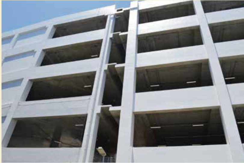
◀ランプウェイ(左)と 倉庫(右)のエキスパンション・ジョイント
