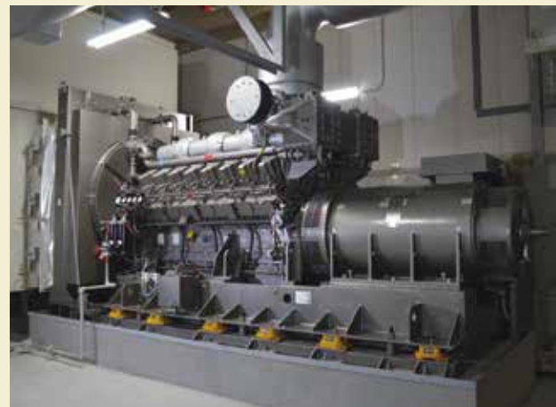
大型非常用発電機を設置 9000リットルの容量タンクを持ち、3日間の最低電力を維持
