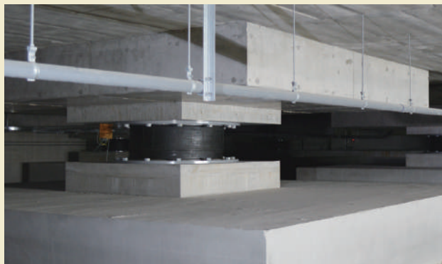
ピット内にあるブリヂストンの免震装置(計241基を設置)
