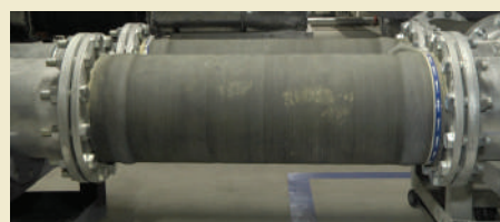
基礎スペースにある空調用冷却水配管
