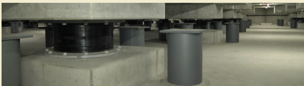
三越日本橋本店本館地下の免震ゴム 鉛プラグ入り積層ゴムと弾性すべり支承を合わせて314基の免震装置が13万トンの建造物を支えています。
