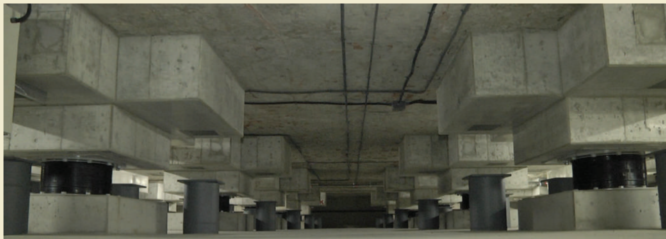
314基の免震装置が建物を支えます。東日本大震災直後に点検を実施しましたが、異常はありませんでした。
