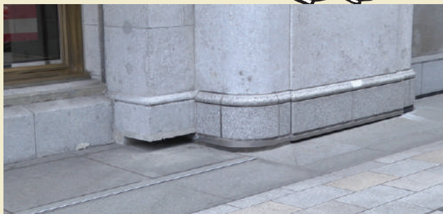
本館の外周にはエキスパンションジョイントがあります。免震建物と周囲の間にすき間を作り、周囲にぶつかったり力が伝わらないようにします。
