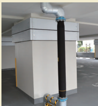
免震装置が組み込まれた柱
